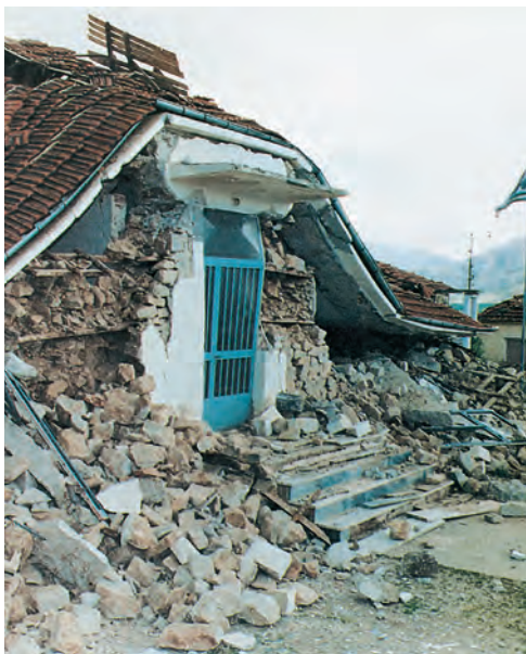
Εικόνα 27.1α: Καταστροφή από σεισμό
