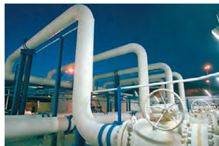
Εικόνα 39.2: Εργοστάσιο Δ.Ε.Π.Α. (ΔΗΜΟΣΙΑ ΕΠΙΧΕΙΡΗΣΗ ΑΕΡΙΟΥ)
